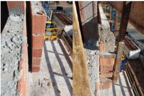
Figura 02 – Muretas antes e depois da solução desenvolvida em obra para solução da inclinação não prevista.
